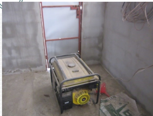
เครื่องสำรองไฟ
