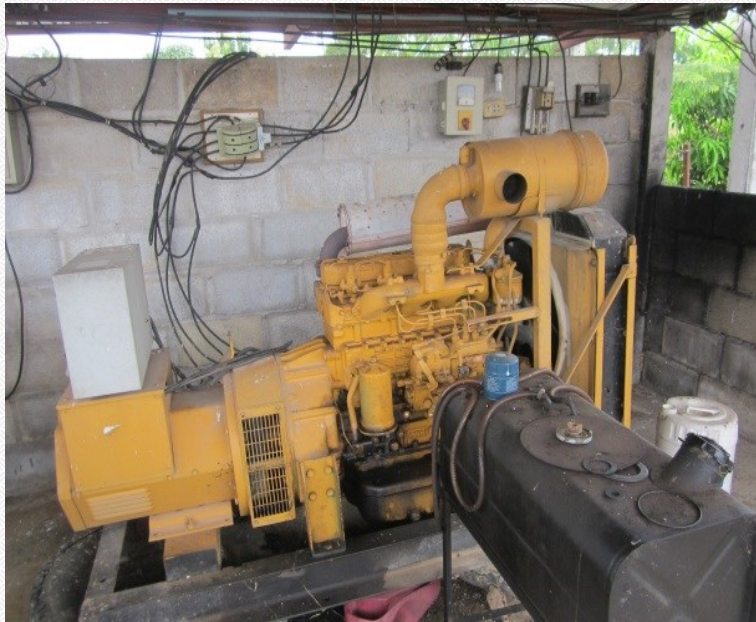
เครื่องสำรองไฟ
